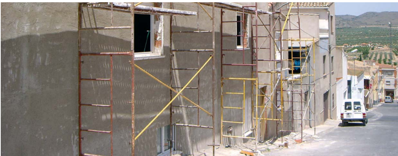
Andamio de tijera. Elevado riesgo de caída de altura. Obra en el año 2009.
