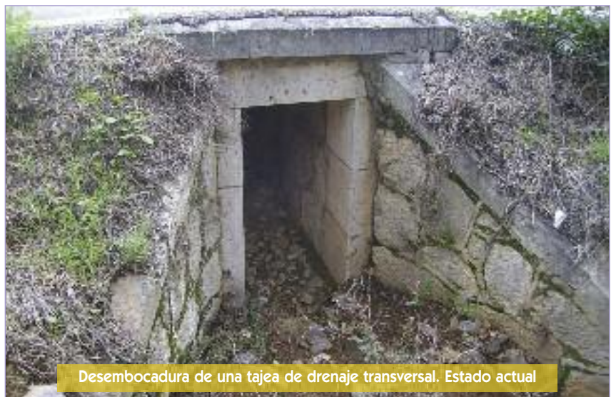
Pontón. Estado actual
